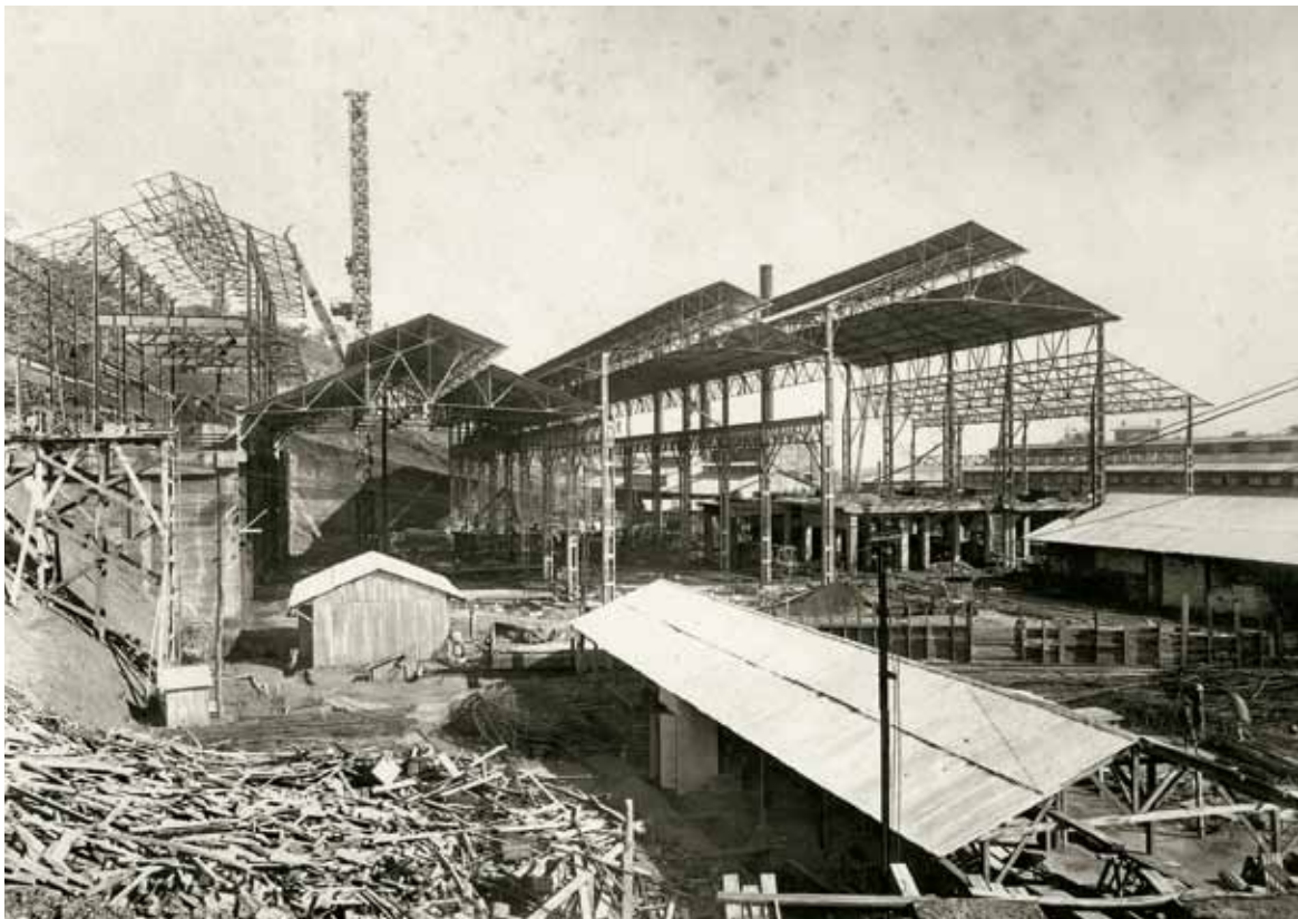
Bâtiments de l'usine en construction, vers 1917 ? Reproduction d'une photographie ancienne. Fonds Gécamines, Fondation Forrest, médiathèque ECFL.
