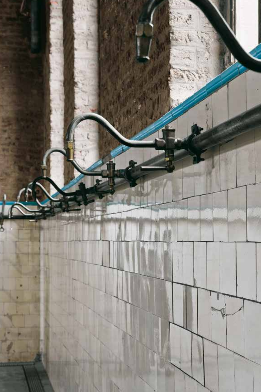
139 ← LEWARDE, FOSSE DELLOYE Après la remontée, direction les bains-douches qui font leur apparition dans les fosses après-guerre. Les photographies anciennes (Joseph Quentin (1857-1946) par exemple) montraient les mineurs se baignant chez eux; un autre photographe, Paul Walet, né en 1929, les dévoile au travail, avant la descente et après la remontée.
