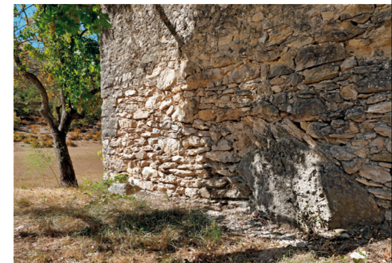
Mise en œuvre irrégulière s'appuyant sur un bloc en place (La Palud-sur-Verdon).
