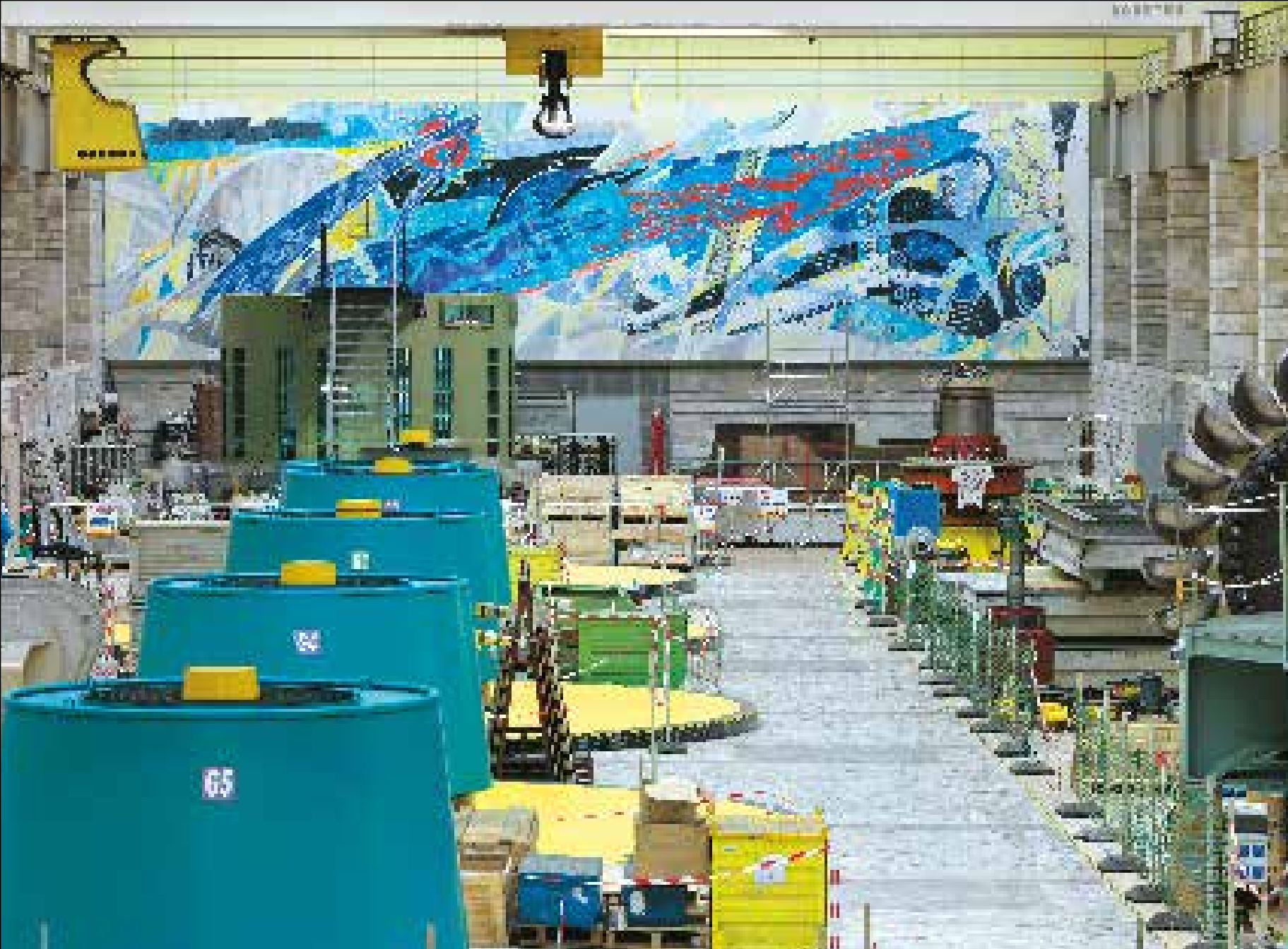
Vue intérieure de la centrale de La Bathie (73), construite en 1961.
